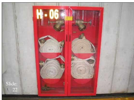
Hidrantes – Tipo Parede.
