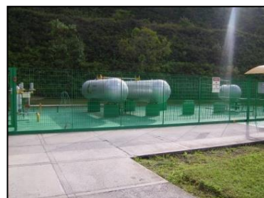
Central de gás
