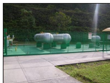
Central de gás
