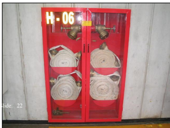
Hidrantes – Tipo Parede.
